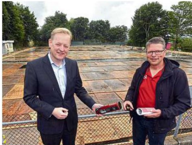
Im Hintergrund laufen die Arbeiten für das Fundament der neuen Halle des TC Niederursel. Sportdezernent Markus Frank (l.) und der Vorsitzende Udo Sauerbrey bereiten derzeit die etwas ungewöhnliche Zeitkapsel vor. FOTO: RÖFFER
